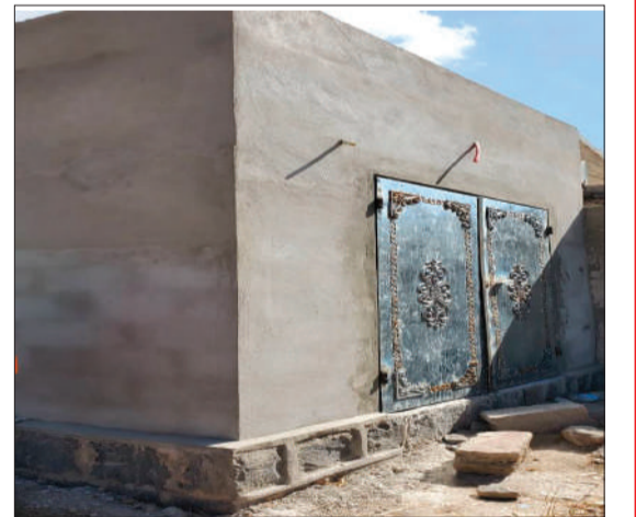
عمل غرفة المضخة المحول الطاقة الشمسية
